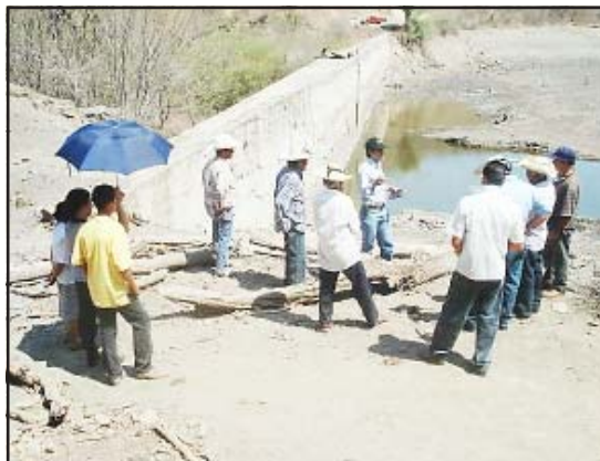
Ingenieros de la Secretaría de Desarrollo Social y de Obras Públicas Municipales, en compañía del presidente municipal de Carácuaro, Román Nava Ortiz, así como de varios habitantes de La Cañada de Los Limones, inspeccionaron los daños que tiene la cortina de contención de la presa para su pronta reparación.
