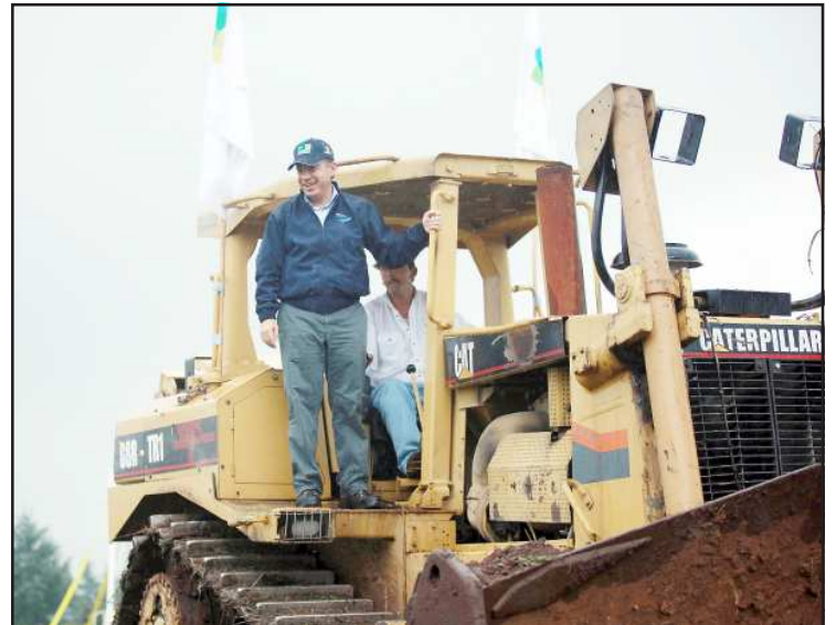
El Presidente Felipe Calderón, después de dar el banderazo de arranque a las obras de construcción del libramiento vehicular de carga pesada en la ciudad de Morelia, abordó una de las máquinas con las que se iniciaron los dichos trabajos.
