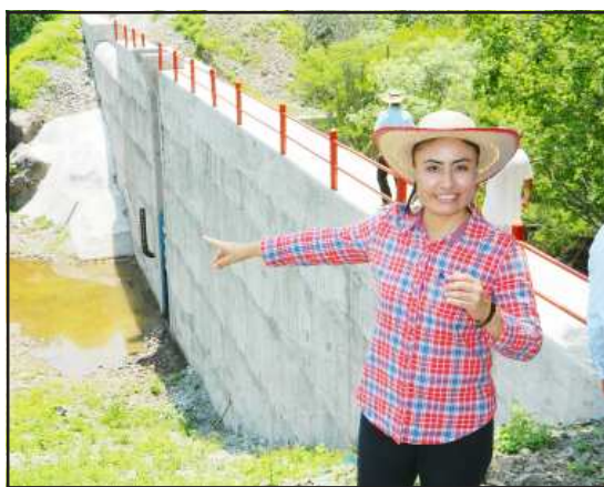
La presidenta Dalia Santana, muestra el avance de construcción de la cortina de la presa en la comunidad Las Trincheras.
