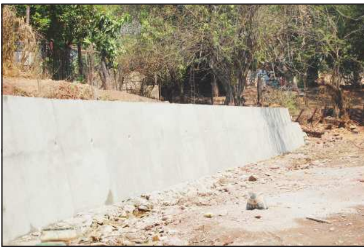
Con la construcción de un bordo en la localidad de Copándaro, del municipio de Tiquicheo, a sesenta familias se les protegerá de los desastres que ocasionan las lluvias.
